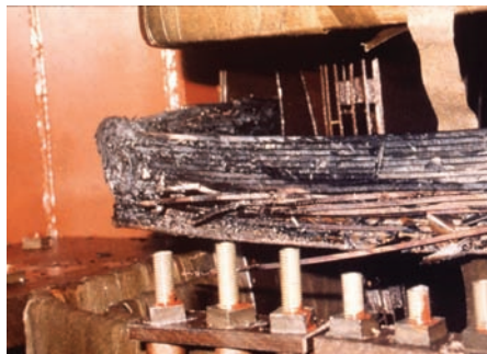
Transformátor zničený v průběhu geomagnetické bouře v elektrárně v New Jersey, 1989.
